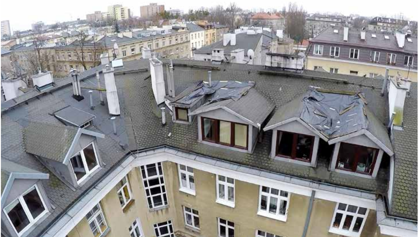
▲ Dach przed remontem przeciekał praktycznie wszędzie – widok od podwórka
